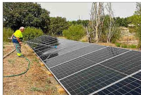
Placas solares en la EDAR Mancomunada del Pla.
